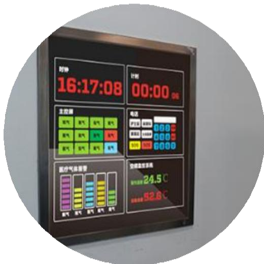
手术室·无接触控制系统
